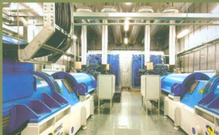
Geradores de energia
